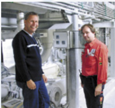
SCAs instrumenttekniker Lars-Åke Westberg och Bürkerts Kjell Ljungberg framför det nya tätvattenslåpet.
